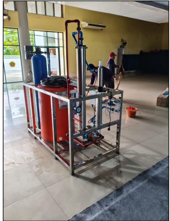
Gambar 2. Instalasi peralatan filtrasi Air Sumur
