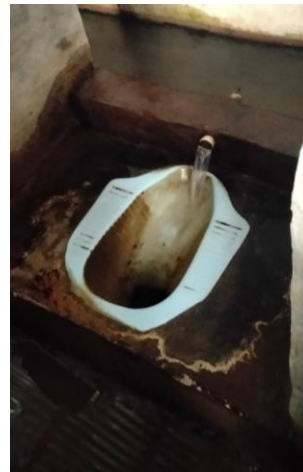
Hasil Dokumentasi Jamban Yang Tidak Memenuhi Syarat
