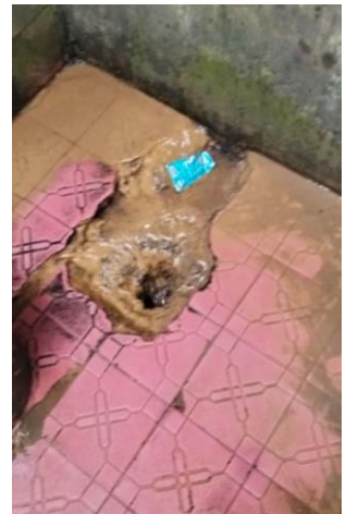
Hasil Dokumentasi Jamban Yang Tidak Memenuhi Syarat
